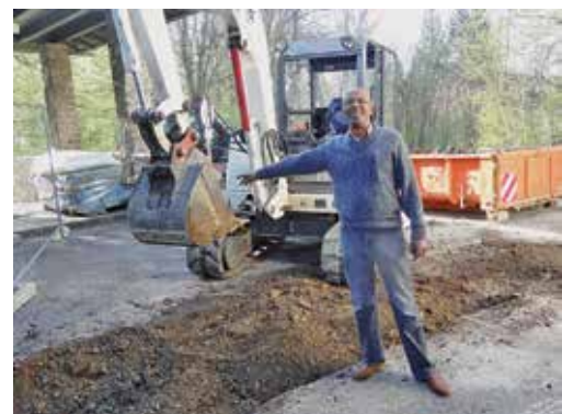
Jetzt rückt der Bagger an. Zum Zweck der energetischen Sanierung in allen Gebäuden werden Leitungen zwischen Gemeindehaus, Kirche und Pfarrhaus verlegt.
