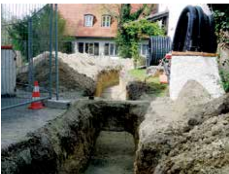
Die Tiefbau-Arbeiten laufen wie geplant. Auch die maroden Elektro-Kabel werden neu verlegt.
